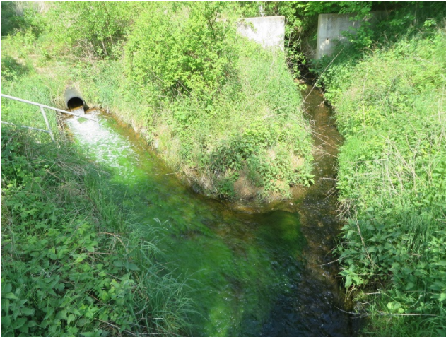
Einleitung der WBA Ronneburg (mündet im späteren Verlauf ins Gewässer Wipse), Foto: TLUBN
